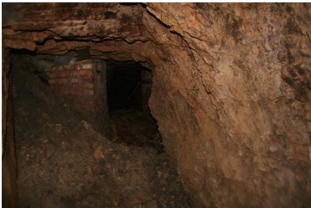
Einstürzungen im Zugangsbereich
